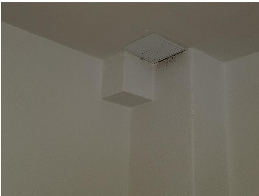
Billede 4. Udsugningskanal fra køkken, 1. sal.
