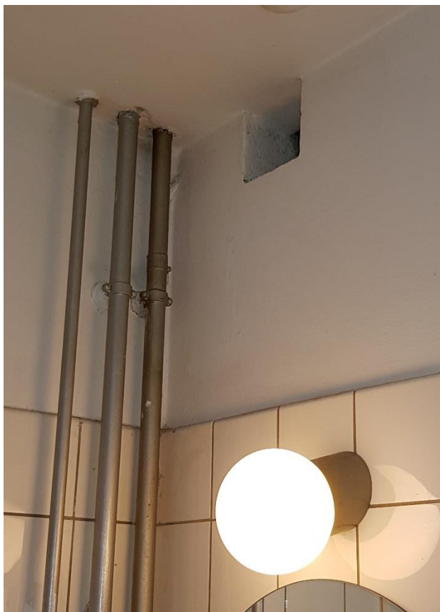
Billede 1. Udsugningskanal i badeværelse, 1. sal
