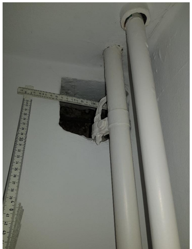
Billede 2. Udsugningskanal i badeværelse, stueetagen.
