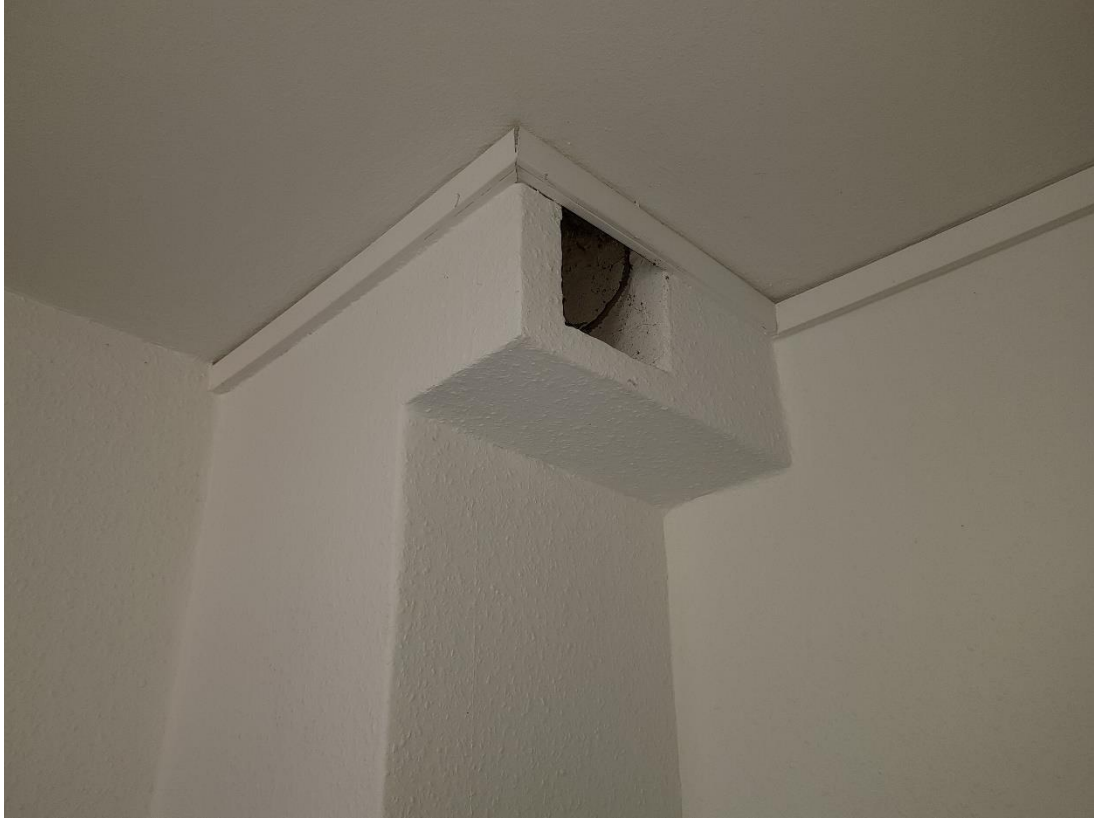
Billede 5. Udsugningskanal fra køkken, 2. sal.
