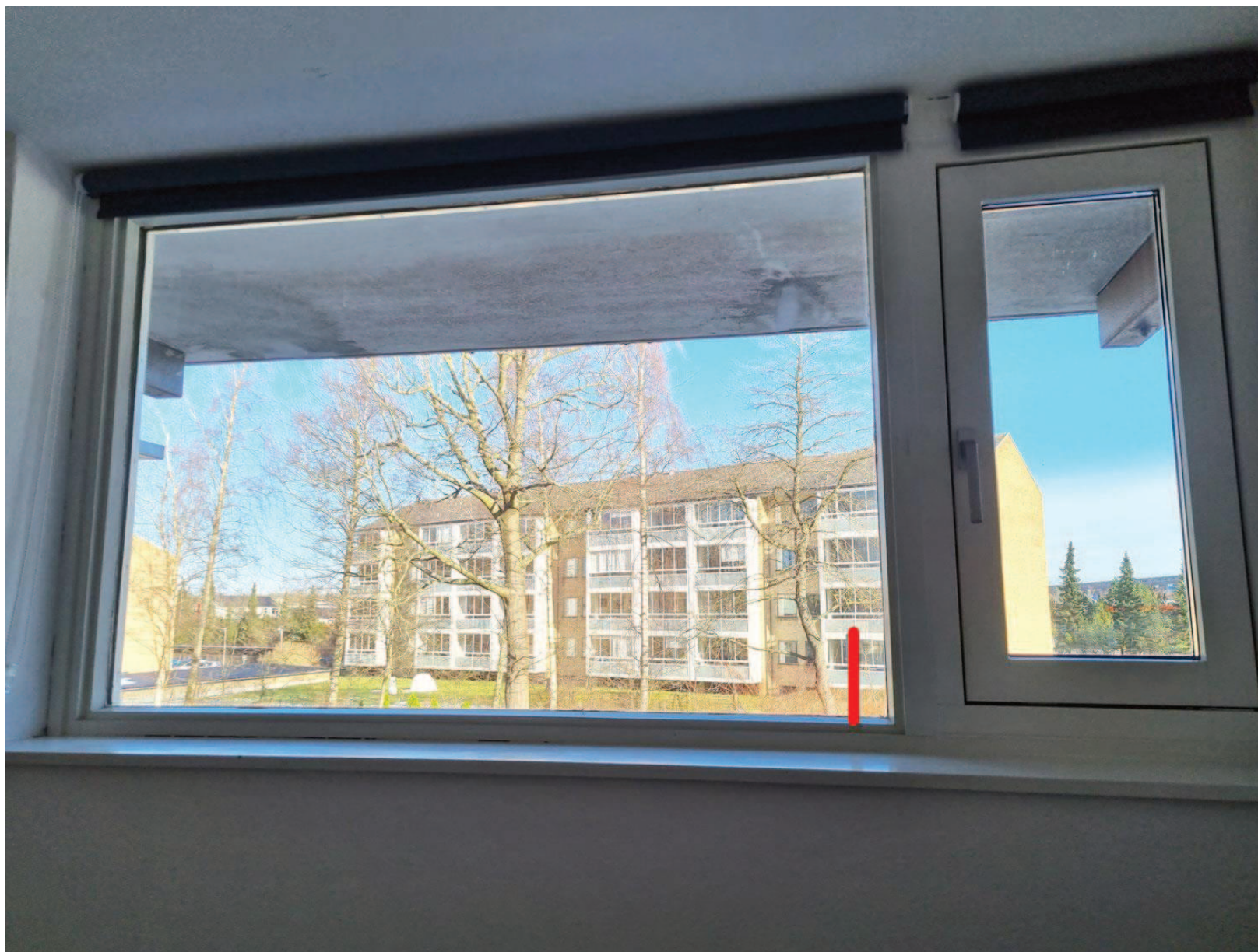
Eksisterende dreje-/kipvindue på svalegangssiden med flg. mål: bredde 551 x højde 1003 mm. I KPK's oversigt er målene for firmaets smalleste vindue: bredde 563 x højde 1003 mm = 12 cm bredere . Den røde markering viser hvor langt det smalleste vindue fra KPK rager ind over den faste termorude (målt fra højre karm).
