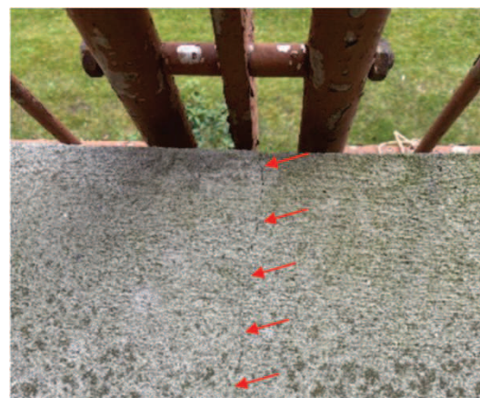
Revne fra rustent indstøbt stål (værn)
